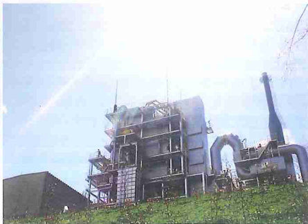
㈱バイオパワー勝田の木質バイオマス発電所
