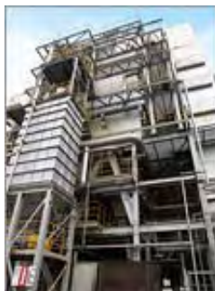
流動層ボイラー。ここで木材チップを燃やし、蒸気を発生しています
